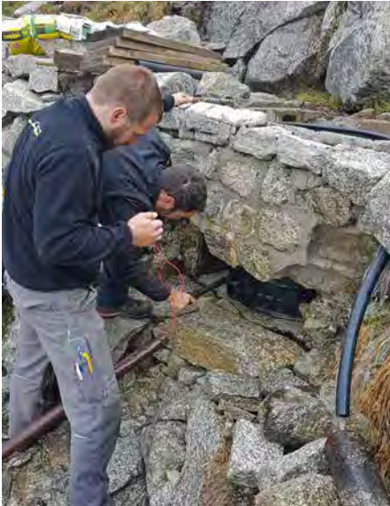
Die Frontmauer ist teilweise ausgebrochen und der Heizdraht kaputt. Rechts sieht man den Bypass für das Bergwasser.
